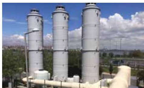
Biotricklingfilter entfernen Gerüche von der Kläranlage
