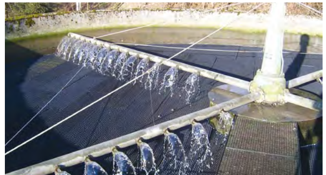
2+ BIOdek® Sanierter Tropfkörper mit Beschickung im freien Gefälle
