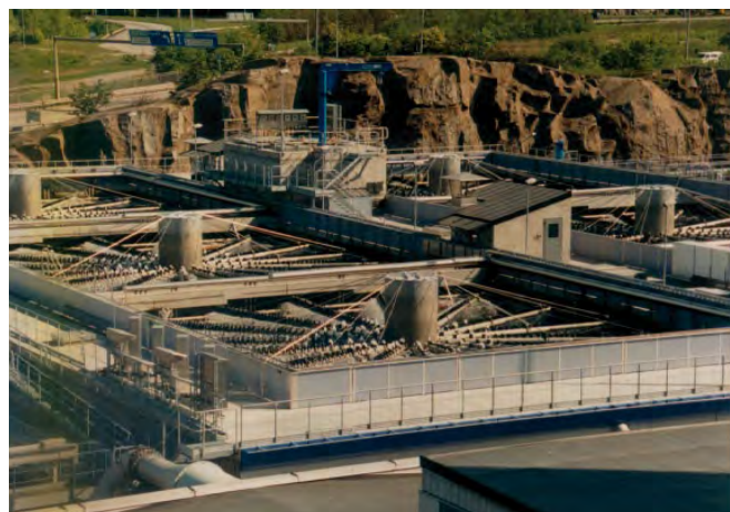
2H BIOdek® Nitrifikationsanlage Göteborg, Schweden
