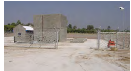
2H BIOdek® Namibia: Tropfkörper als Verfahren mit der größten Verlässlichkeit für kleine Anlagen bei knapper Energieversorgung.
