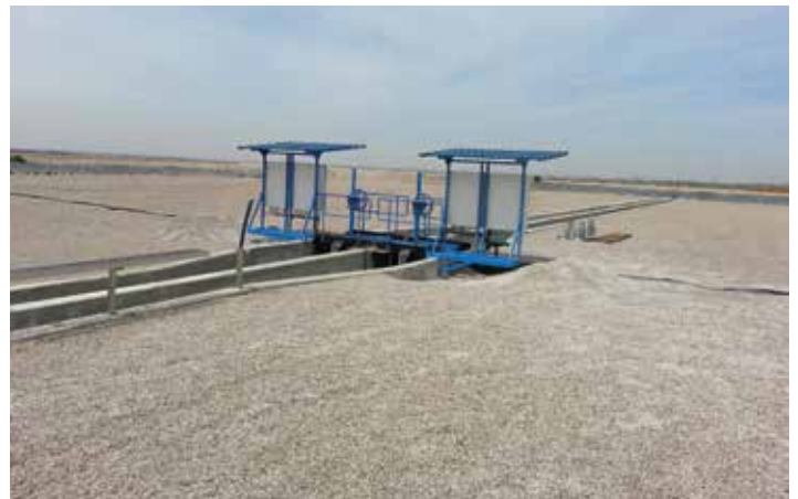
Anlage mit TAYA-Technologie
