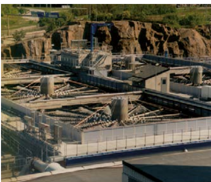
Nitrifikationsanlage in Göteborg, Schweden
