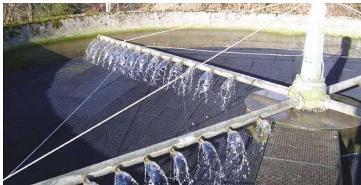
Saniertes Tropfkörper mit Beschickung im freien Gefälle
